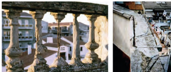
Fig. 43.1. Ejemplos de alteración y desprendimiento de piedra artificial afectada por la corrosión de la armadura metálica.
