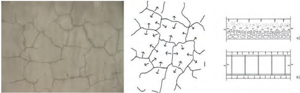
Fig. 8.3. En la foto izquierda, detalle del trazado típico de las grietas de afogado. En el gráfico central, representación de las tensiones de retracción causantes de las grietas. En el gráfico superior de la derecha, solera de hormigón con grietas de afogado debido a la acumulación de árido fino en la parte superior por exceso de vibrado; en el gráfico inferior, nervio de hormigón armado con grietas de afogado en el recubrimiento de la pieza, inducidas por el efecto rigidizador de la armadura sobre el núcleo interior.
