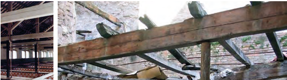
Fig. 18.3 Cercha y biga de madera con presencia de fendas longitudinales originadas en el periodo de secaje.
