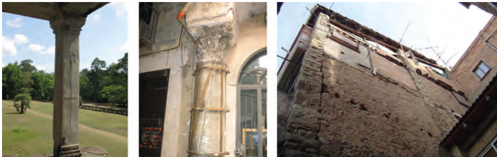
Fig. 11.2. A la izquierda y en el centro, pilares de piedra con fracturas debidas a las cargas verticales. En la foto de la derecha, pilar en esquina abombado por los efectos de la carga excéntrica.
