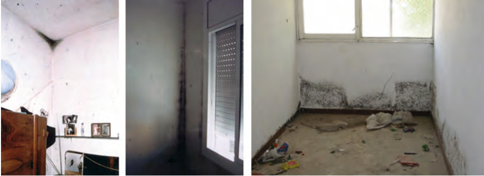
Fig. 44.1. Ejemplos de formación de moho en localizaciones con escasa ventilación, en rincones de los paramentos y detrás de los muebles adosados.
