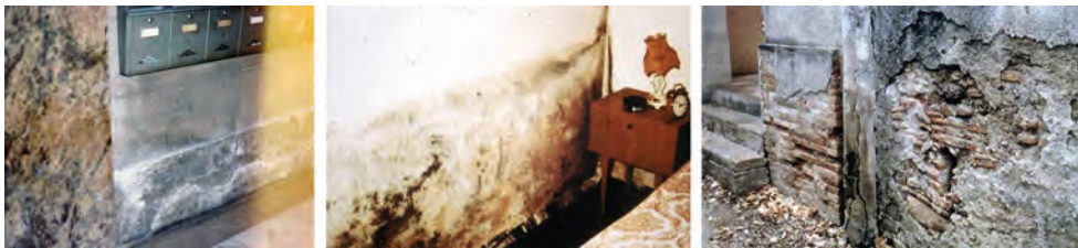
Fig. 33.2. Eflorescencias salinas aureolando las manchas de humedad ascensional. En la foto de la izquierda, vestíbulo de edificio urbano con manchas producidas por la rotura del albañal. En la foto del centro, formación de moho en un muro húmedo de planta baja. En la foto de la izquierda, deliquesencia del revestimiento exterior producido por la presencia continuada de agua.
