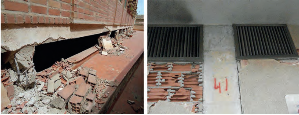
Fig. 31.5. Pilar corto y pilar con el movimiento impedido por los entrepaños de obra con roturas a cortante por efecto del sismo.
