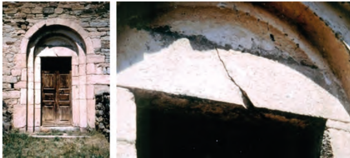
Fig. 12.1. En las fotos, dintel formado por una sola pieza de piedra, con rotura por el centro del vano. En los gráficos, dos formas y despieces de arcos con dovelas.
