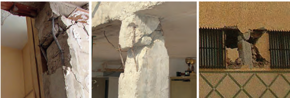
Fig. 31.4. Cabezas de pilares de hormigón armado afectados por movimientos sísmicos.
