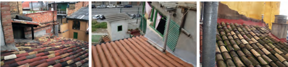
Fig. 53.4. Ejemplos de sucesivas intervenciones de cambios puntuales de tejas o de incorporación de nuevos conductos de ventilación e instalaciones diversas.
