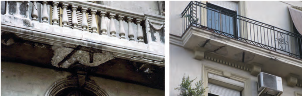
Fig. 24.2. Ejemplo de dos balcones soportados por viguetas metálicas con el revestimiento inferior desprendido por los efectos de la corrosión de los perfiles.
