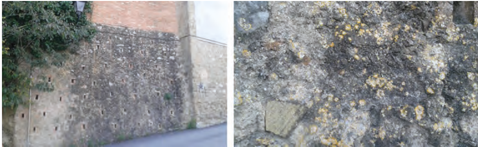
Fig. 51.2. En la foto de la izquierda, crecimiento de líquenes, hongos y musgo sobre una pared de mampostería. En la foto de la derecha, crecimientos de líquenes (manchas ocre) y hongos (manchas oscuras).
