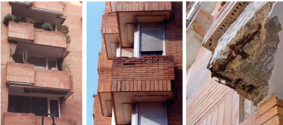
Fig. 45.1. Ejemplos de daños originados por las filtraciones de agua del riego de las jardineras: manchas y pérdidas de material en los muretes cerámicos de media asta que conforman los vasos. En la foto de la derecha, oxidación de la armadura del forjado que soporta la jardinera.
