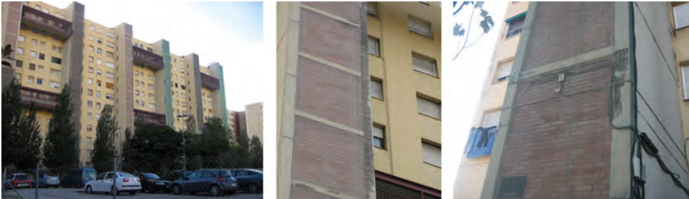
Fig. 9.4. Corrosión generalizada en la estructura de hormigón armado de los núcleos verticales de acceso de un barrio residencial en Barcelona. En la foto de la izquierda pueden observarse diversos núcleos recubiertos con mallas protectoras como medida cautelar.
