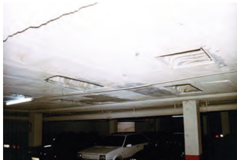
Fig. 23.3. Ejemplos de casetones de yeso rotos coincidiendo con tramos de paso del coche-grúa de retirada de vehículos de la vía pública.
