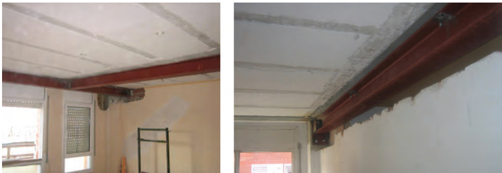
Fig. 5.8. Disposición de perfiles metálicos en H por debajo de las jácenas planas objeto de refuerzo por insuficiencia de inercia. El retacado se efectúa con mortero inyectado.
