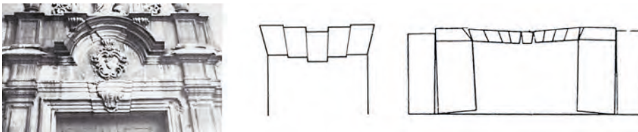
Fig. 12.2. En la foto izquierda y gráfico central, dinteles de piedra adovelados con los arranques movidos por la acción de las cargas. En el gráfico de la derecha, esquema de fisuración del mismo tipo de dintel originado por la misma acción que los anteriores.
