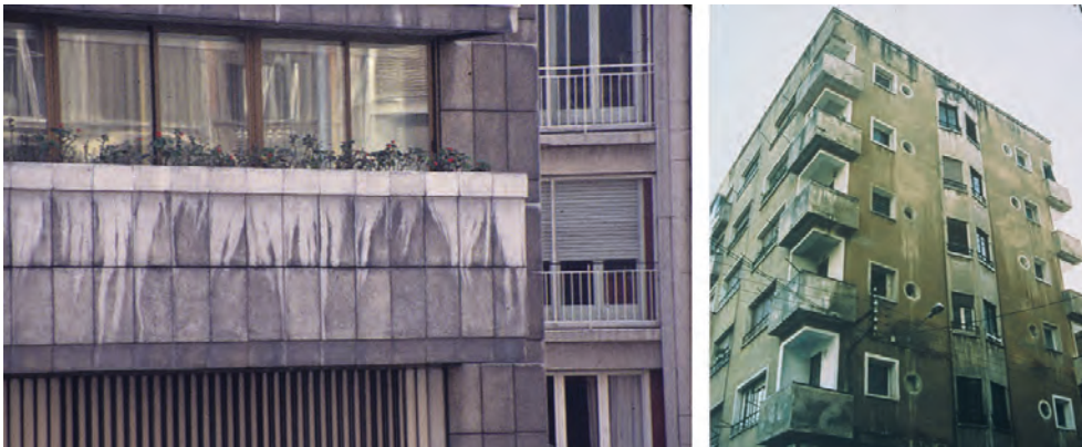
Fig. 51.1. Manchas de suciedad por la adherencia de partículas sólidas en suspensión, mayormente producto de la combustión de hidrocarburos.
