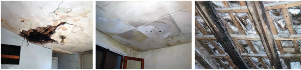
Fig. 53.2. En las fotos de la izquierda y el centro, daños en los falsos techos afectados por filtraciones a través de la cubierta de tejas. En la foto de la derecha, tejas con signos de humedad en su intradós.
