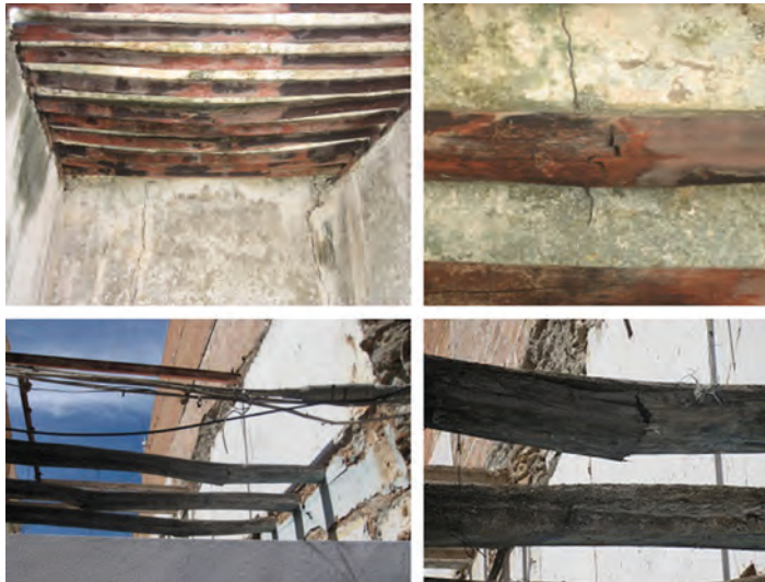
Fig. 18.1. Fractura por la parte inferior y central de algunas de las viguetas de un forjado, en la zona que experimentó mayores tensiones de tracción.
