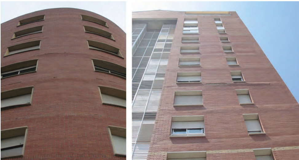
Fig. 36.3. Abombamientos progresivos y desprendimientos de tramos de muros en edificios de altura superior a las 12 plantas.
