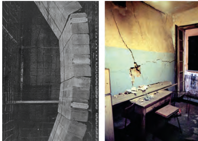
Fig. 4.3. En la foto de la izquierda, colapso por pandeo general de un muro de media asta de 12 cm de grosor sometido a compresión, ensayado en laboratorio. En la foto de la derecha, estado de un muro después del colapso por exceso de compresión en un edificio del casco antiguo de Génova.
