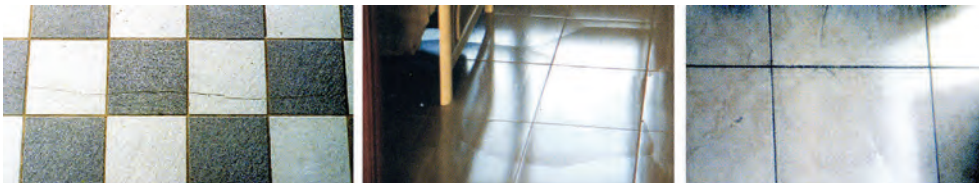
Fig. 58.3. En la foto de la izquierda, grieta formada en solado sobre capa excesivamente compresible. En las fotos central y derecha, grietas siguiendo recorridos de grietas de retracción en las soleras.
