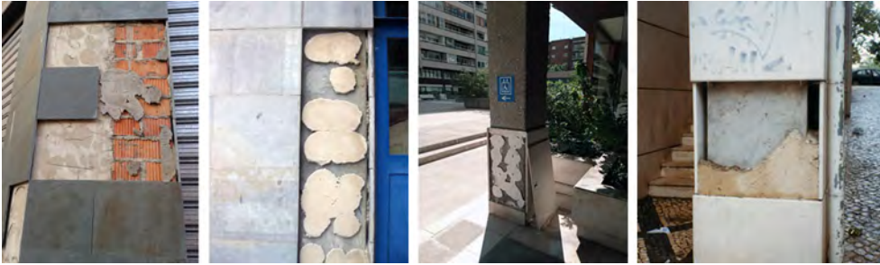
Fig. 40.2. Ejemplos de deficiente colocación del mortero de agarre. En las tres fotos de la izquierda, sin disposición de anclajes.
