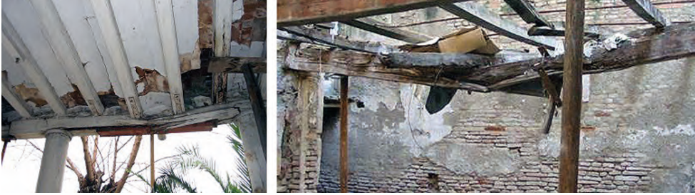
Fig. 18.2. Ejemplos de rotura astillosa en vigas de madera.
