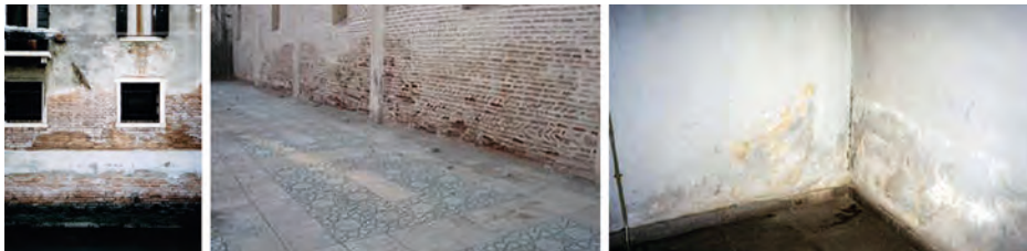
Fig. 33.1. Visión de las manchas de humedad por el exterior de una fachada de ladrillo y por el interior de una esquina de un muro enyesado.
