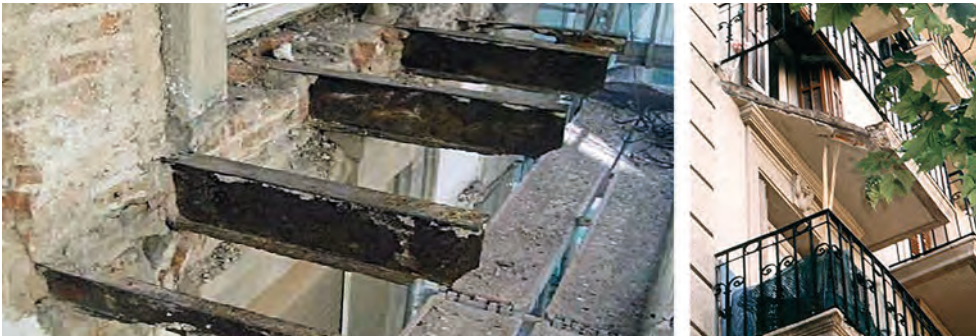
Fig. 24.3. Ejemplos de situaciones ruinosas generadas por la corrosión de los perfiles metálicos. En la foto de la izquierda, balcón con perfiles perforados en sus almas por la corrosión. En la foto de la derecha, tramo de losa de balcón colapsada por el mismo motivo.
