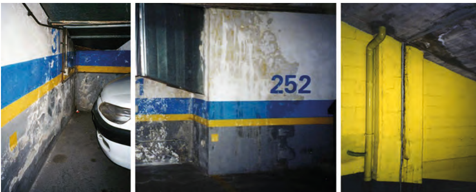
Fig. 34.1. Humedades en los muros de contención de hormigón armado de un sótano destinado a aparcamiento de vehículos. En la foto central se distingue claramente la coincidencia de una de las manchas con una fisura y en la de la derecha con la entrega superior del muro con el forjado.
