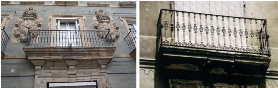
Fig. 27.3. Ejemplos de movimiento de las losas de piedra. En la foto de la izquierda se visualiza el corte total del edificio y el giro del dintel inferior apuntalado.
