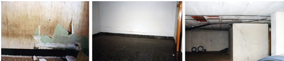
Fig. 19.2. Ejemplos de rotura de tabiquerías originadas por la flexión del forjado y la consiguiente pérdida de apoyo de su parte central.
