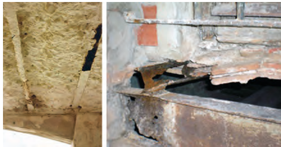
Fig. 24.1. En la foto de la izquierda, viguetas metálicas con el ala inferior fuertemente corroída, en contacto con entrevigado de mortero de cal. En la foto de la derecha, alma de una vigueta metálica completamente corroída en un forjado formado por revoltones de rasillas de dos capas de grosor en una galería exterior de un edificio de viviendas.
