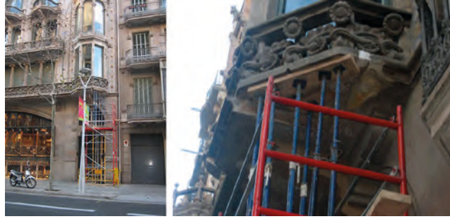
Fig. 27.2. Desprendimiento de una porción de losa de piedra de la parte inferior de una tribuna, después de adoptar medidas preventivas.
