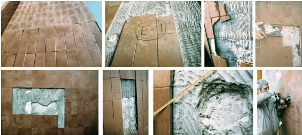
Fig. 39.2. Anomalías típicas en revestimientos de losetas cerámicas. Fotos superiores, de izquierda a derecha: a) Losetas colocadas a tope, desadheridas del soporte, con alta probabilidad de desprendimiento en tiempo ventoso o de alta temperatura. b) La visión del estriado del mortero indica que la presión de la loseta sobre el soporte fue escasa. c) Tramo de revestimiento con desadherencias del mortero al soporte y de la loseta al mortero. d) Rotura parcialmente cohesiva por el hormigón ligero del soporte y por el mortero de agarre. Fotos inferiores, de izquierda a derecha: e) Carencia de planeidad entre el pilar y el cerramiento de hormigón ligero corregido irregularmente. f) Doble plano de desadherencia entre loseta, mortero y soporte. g) Grosor de mortero de agarre excesivo. h) Momento de la ejecución de un ensayo de extracción pull-off.
