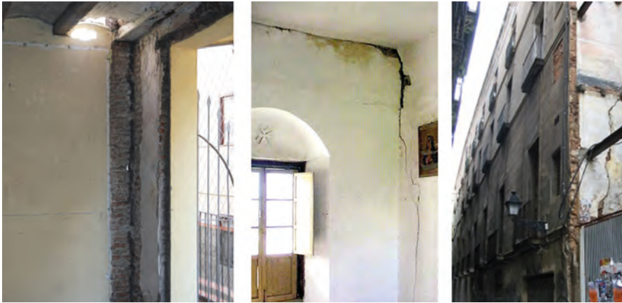
Fig. 2.2. Ejemplos de las grietas formadas entre el muro de fachada y el de medianería, o en la propia medianería o muros transversales como consecuencia de las tracciones generadas por el abombamiento progresivo del muro de fachada.
