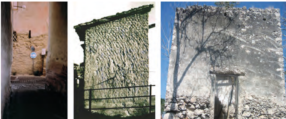
Fig. 3.1. En la foto de la izquierda, tramo de muro de tierra dando frente al viento canalizado por un callejón, con los síntomas del desgaste originados por los constantes ciclos de secado y desecado a que se halla sometido. En la foto del centro, acción protectora del alero en la parte superior del muro frente al desgaste ocasionado por la lluvia y el viento. En la foto derecha, debilitamiento de un muro de mampostería prácticamente sin material en el revestimiento y con un alto contenido de arcilla en las juntas de su parte inferior, fuertemente afectadas por el agua de ascensión capilar del terreno.
