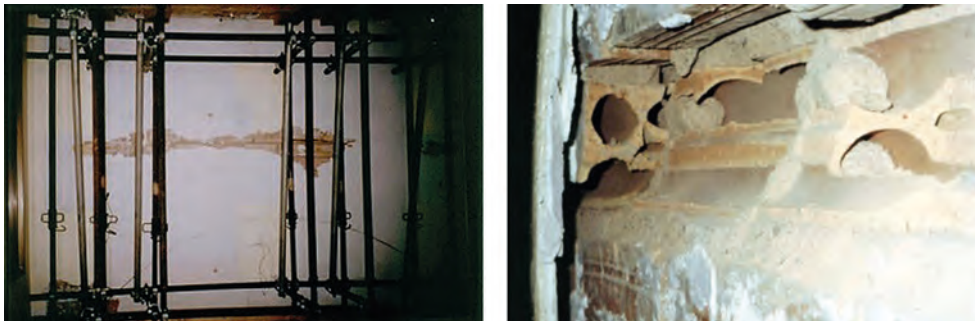
Fig. 4.1. Muro portante de ladrillo hueco de 14 cm de espesor roto bruscamente. En la cala de la foto de la derecha se percibe el aplastamiento de las piezas cerámicas de la hilada intermedia y la rotura vertical central.
