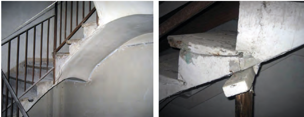
Fig. 26.1. En las fotos de la izquierda, desarrollo de las bóvedas en los muros de las cajas de escaleras. En la foto de la derecha, bóveda fisurada transversalmente convenientemente apuntalada.
