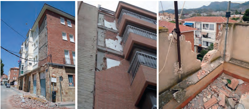
Fig. 31.6. Ejemplos de paramentos y barandillas de las fachadas desprendidas hacia la calle por el efecto del sismo.
