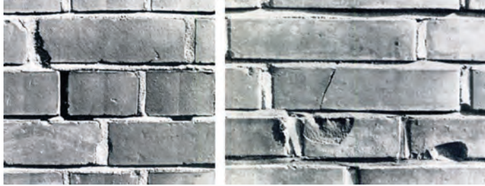
Fig. 46.1. Ejemplos de ejecución defectuosa: juntas verticales sin correcto contacto con las horizontales y presencia de juntas insuficientemente colmatadas
