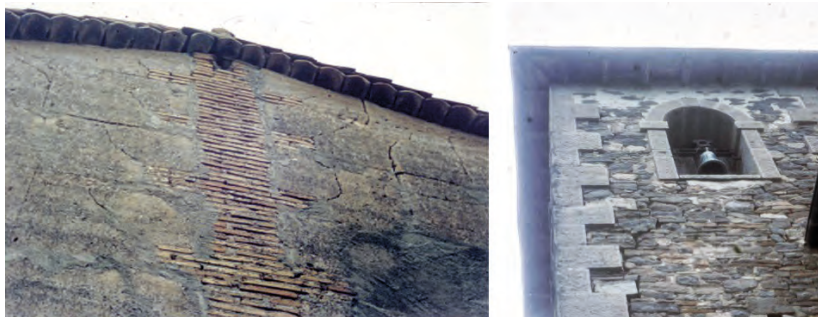
Fig. 1.5. Familias de grietas debidas al cambio de rigidez de los materiales del muro entrelazados. Se marcan a partir de las esquinas superiores del material más rígido, mostrando el descenso del menos rígido.
