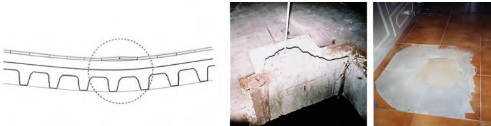
Fig. 58.2. En la figura se representa una de las formas de anomalía del pavimento, que responde al impedimento de deformación inducido por el forjado levantando las piezas y abriendo la junta entre ellas. En las fotos del centro y la derecha, dos casos de pavimento sin previsión de deformación lateral, desadheridos zonalmente de la base. Los movimientos de abombamiento del pavimento pueden estar provocados por la dilatación generada por algún elemento próximo de la calefacción (tubo, radiador, etc.).
