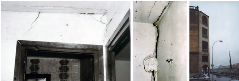
Fig. 28.5. A la izquierda y en el centro, ejemplos de descuadre de puerta y descenso del pavimento de planta baja a causa del movimiento del terreno. A la derecha, un caso de continuación de la grieta por pared y techo.
