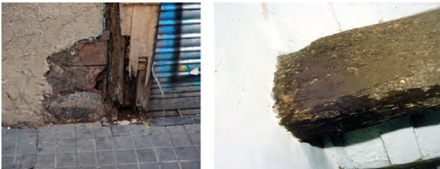
Fig. 13.2. Ejemplos de pudrición de elementos de madera, visibles en la zona próxima a su empotramiento.
