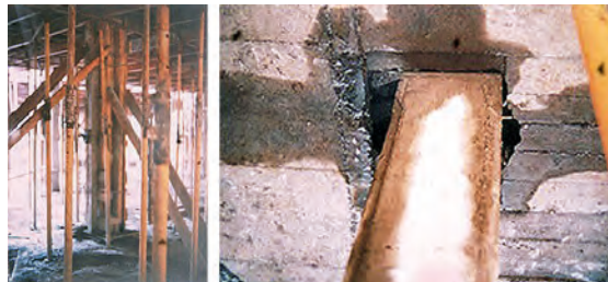
Fig. 16.4. Colapso por punzonamiento de un forjado reticular en un edificio escolar. En la foto derecha, visión de la fractura por el paramento inferior del forjado, en el perímetro del pilar.
