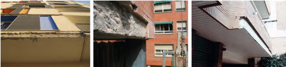
Fig. 41.2. Ejemplos de grosores excesivos por delante del canto del forjado. La foto de la derecha muestra la corrección con el ladrillo del error de replanteo del canto del forjado en dirección horizontal.
