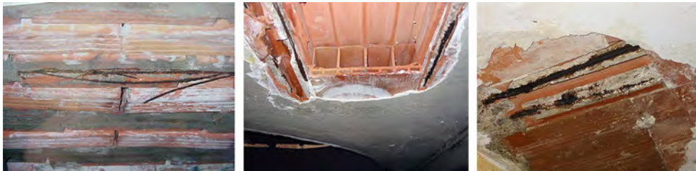
Fig. 22.1. Forjados cerámicos con claros síntomas de corrosión de las armaduras de los nervios.
