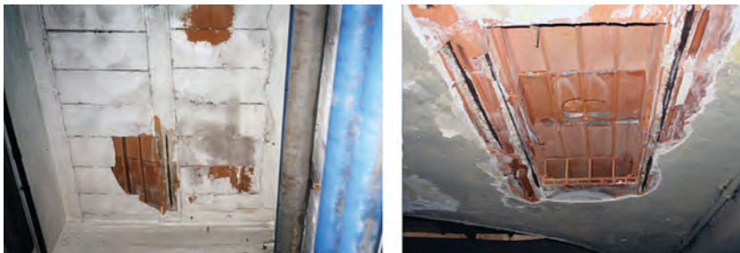
Fig. 23.2. Ejemplos de casetones rotos a causa de la corrosión de las armaduras en los elementos de apoyo.
