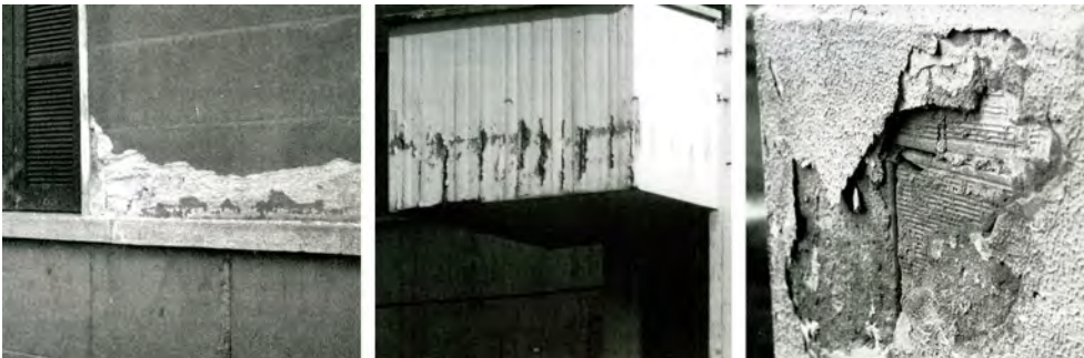
Fig. 48.1. En la foto de la izquierda, la acumulación de agua sobre la moldura de piedra origina la humectación del revoco de la fachada. En la foto central, filtración a través de la barandilla en su contacto con la losa del balcón. En el gráfico de la derecha, el desconchado del revoco se forma justo encima de la junta entre un pilar y la cerámica del cerramiento de obra.
