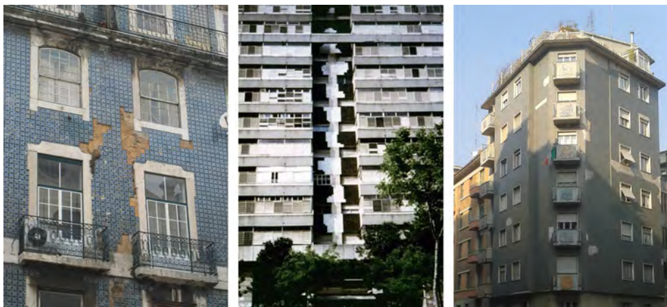
Fig. 39.1. En la foto izquierda, desprendimientos de losetas acaecidos a lo largo de los años sujetas con mortero de cal a un muro grueso. En la foto central, zonas con losetas desadheridas tomadas con mortero cola después de su revisión sistemática por golpeo superficial. En la foto derecha, plaquetas desadheridas con la misma problemática.
