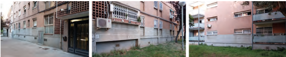
Fig. 35.3. Ejemplos de disposición a posteriori de rejillas de ventilación de las cámaras sanitarias en los edificios de un barrio residencial.
