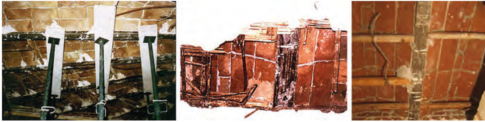
Fig. 21.1. Ejemplos de viguetas fabricadas con cemento aluminoso con síntomas visibles por su coloración marronosa de su proceso de transformación química.
