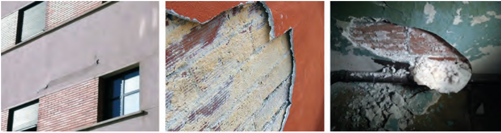
Fig. 37.2. Ejemplos de procesos de desadherencia que muestran, en la foto de la izquierda, la fase de abombamiento anterior a su desprendimiento zonal, en la foto central, los síntomas de desadherencia en el contorno del revoco ya desprendida, y en la foto de la derecha, la presencia de un depósito de sal detrás del revestimiento.
