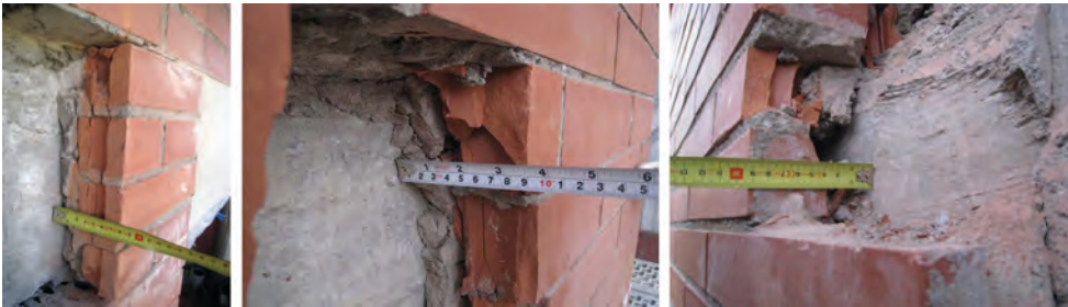
Fig. 36.2. Ejemplos de recubrimientos de cantos de forjado cuyo grosor constata el escaso apoyo del muro en su forjado, y el consiguiente traspaso de cargas a través de los recubrimientos del mismo tipo de ladrillo.
