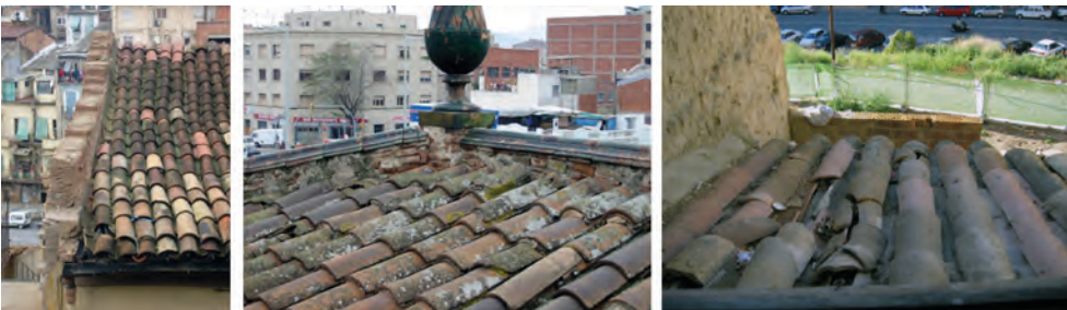
Fig. 53.3. Resolución incorrecta de los encuentros perimetrales de las tejas y presencia de tejas rotas.
