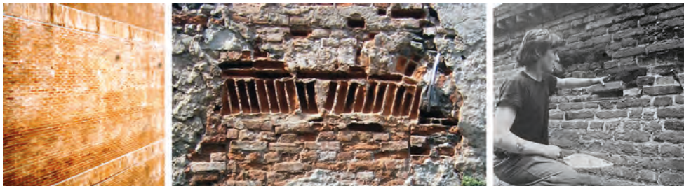
Fig. 49.1. En la foto de la izquierda, muro de ladrillo con eflorescencias salinas. En la foto del centro, un ejemplo de fuerte afectación por la formación de criptoflorescencias en el material cerámico. En la foto de la derecha, un momento de la sustitución de piezas de ladrillo, solo en el grosor de la parte alterada.
